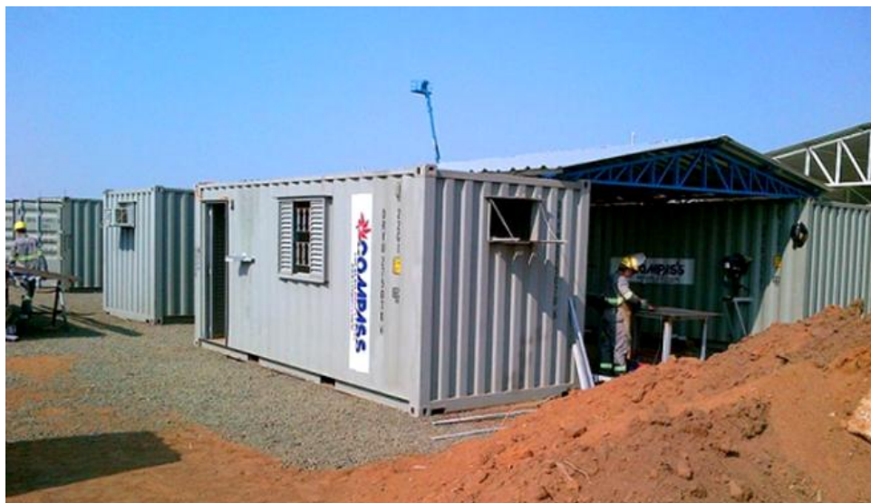
Figura 87 - Escritório em contêineres. Fonte: Compass.
