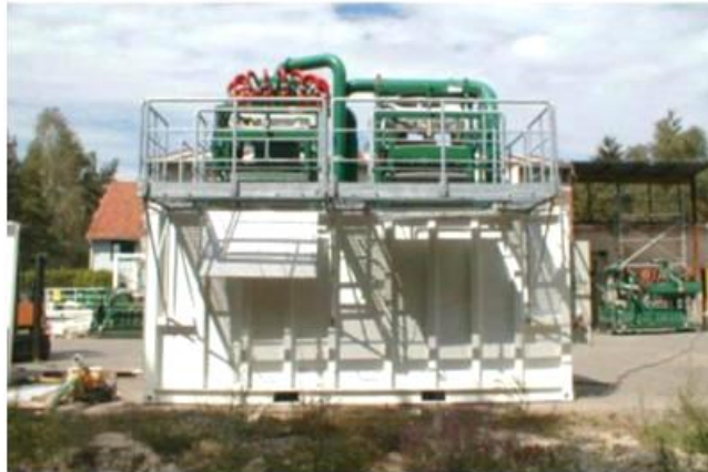
Figura 101 - Sistema de reciclagem.
