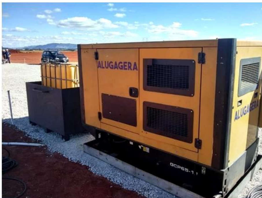
Figura 95 - Gerador de energia a diesel. Fonte: AlugaGera.
